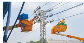
设备运维与不停电作业
